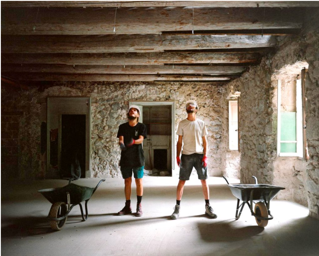
Le Moulinage de Chirols en chantier : le collectif à l'œuvre, 2022 © Lucien Lung
