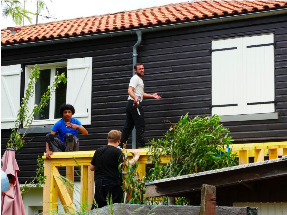
Chantier de réhabilitation des maisons de Claveau avec les Compagnons Bâisseurs, 2018 © Agence Nicole Concordet
