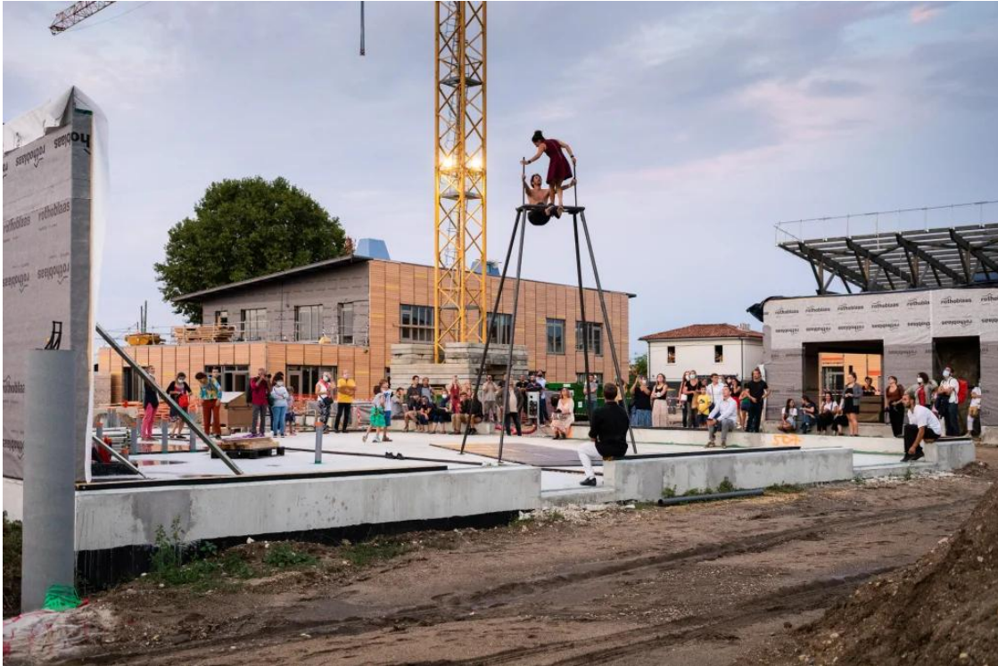
Spectacle de Smart cie sur le chantier de l'école Frida Khalo, Compagnie Architecture, Bruges, 2021, © Compagnie architecture. Photographe : Ivan Mathie
