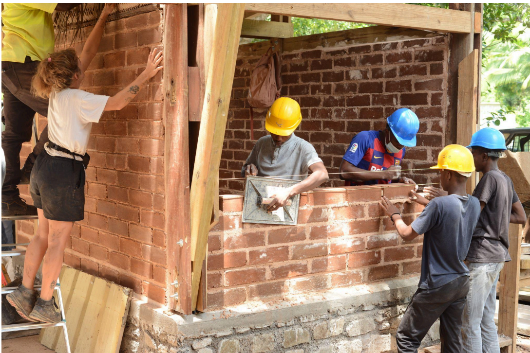
Chantier école, Faré du lycée avec les élèves en CAP maçon du lycée professionnel de Dzoumogné, encadrés par le collectif dallas
